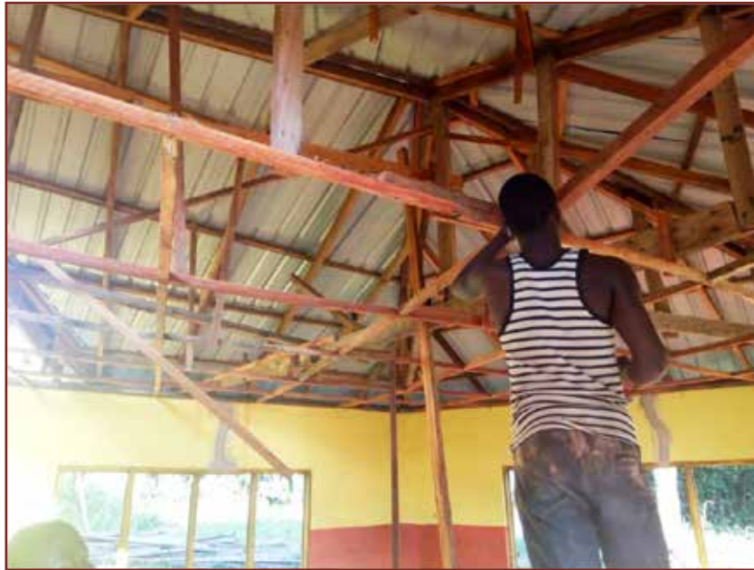
Der ganze Dachstuhl musste erneuert werden
